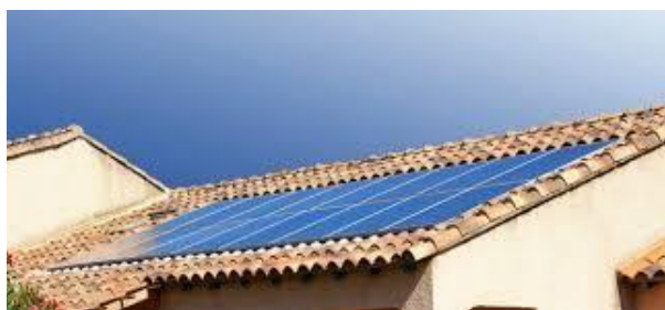
Exemple d'une installation de 6kWc
